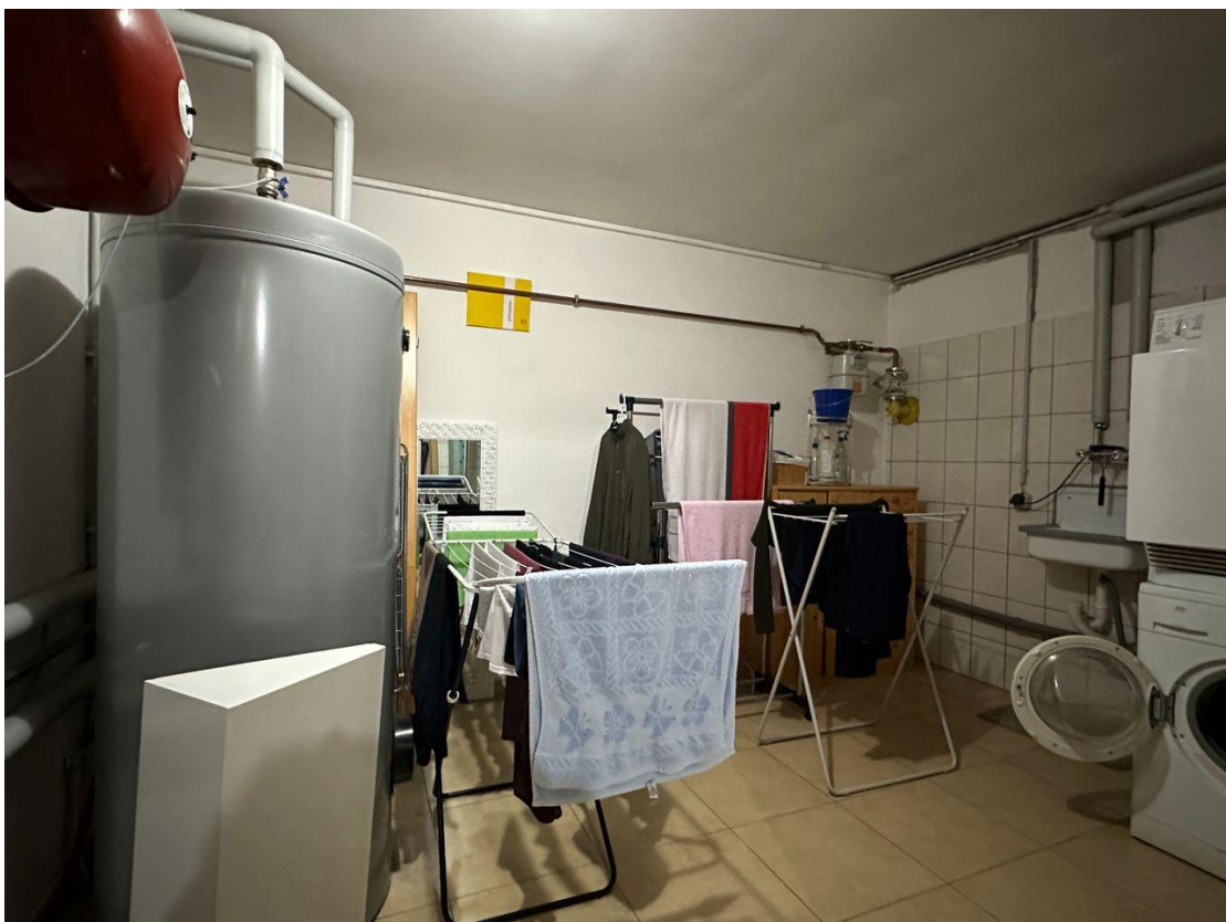
Heizungs- und Waschraum
