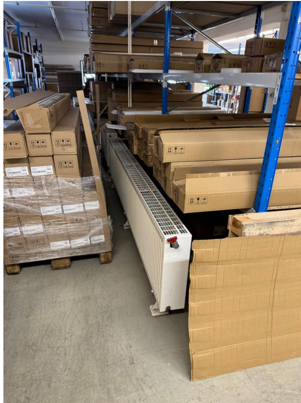
Heizung in der Lagerfläche
