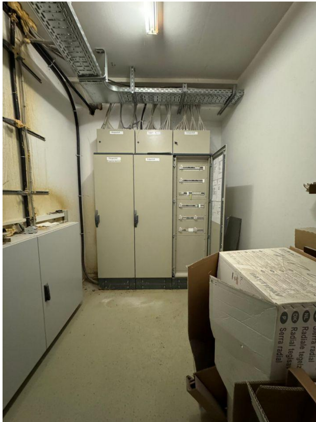
Elektroraum mit Starkstrom
