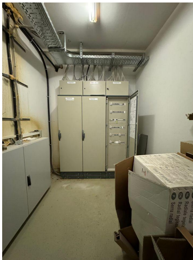
Elektroraum mit Starkstrom
