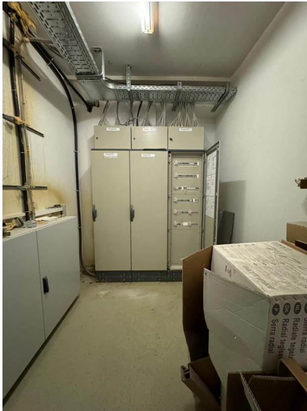
Elektroraum mit Starkstrom
