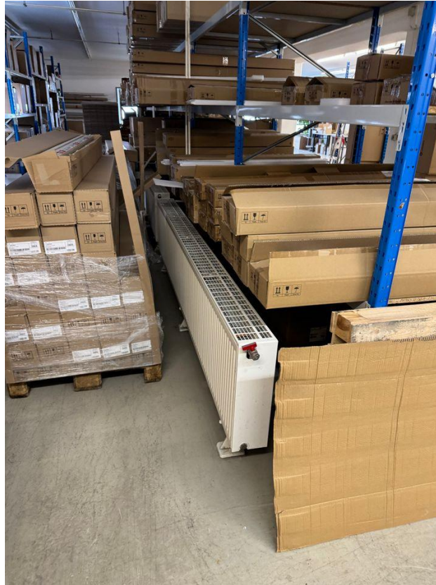
Heizung in der Lagerfläche
