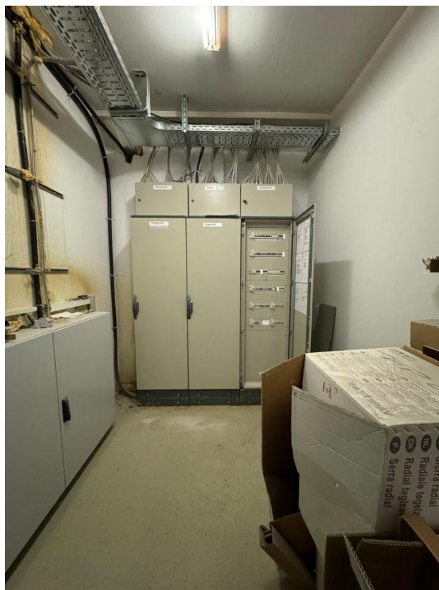
Elektroraum mit Starkstrom
