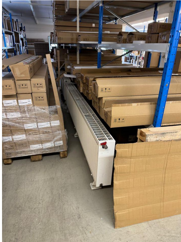
Heizung in der Lagerfläche
