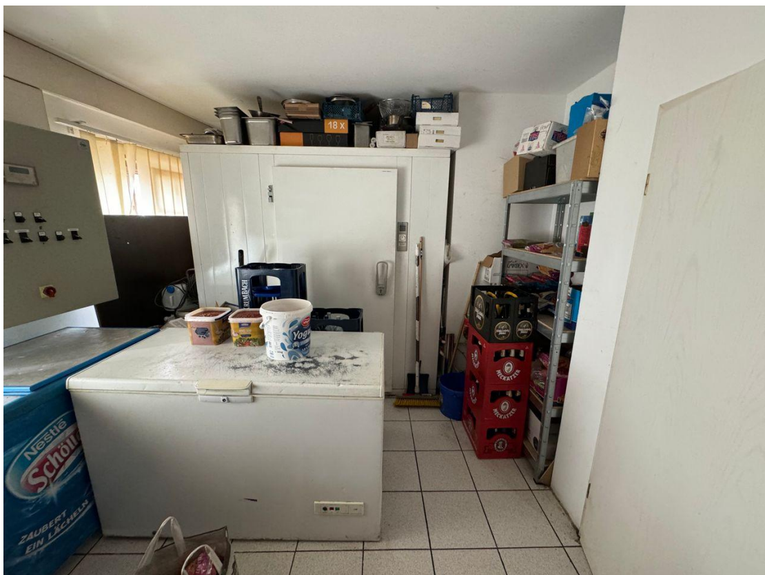
Lagerraum mit Kühlräume
