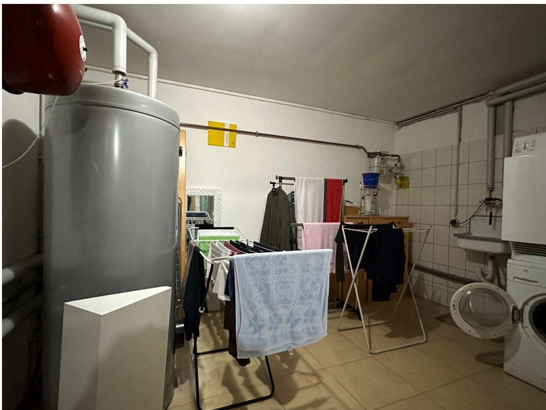
Heizungs- und Waschraum
