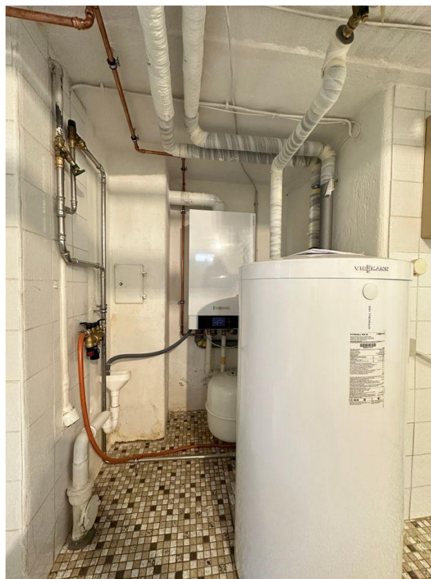
Neue Heizung - Baujahr 2021
