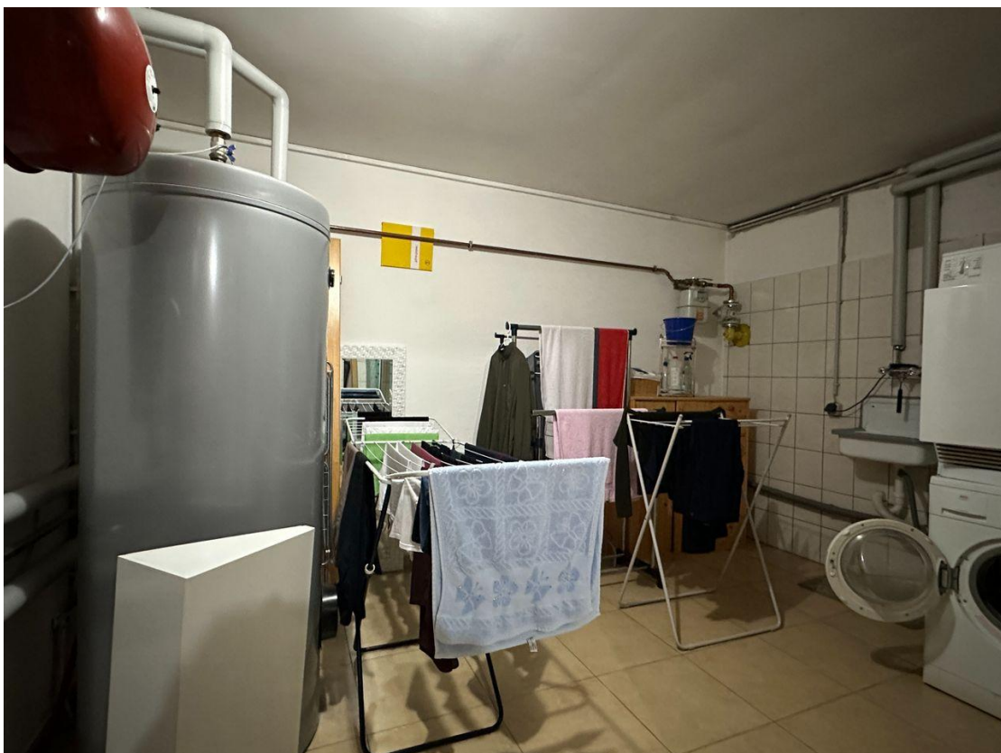
Heizungs- und Waschraum
